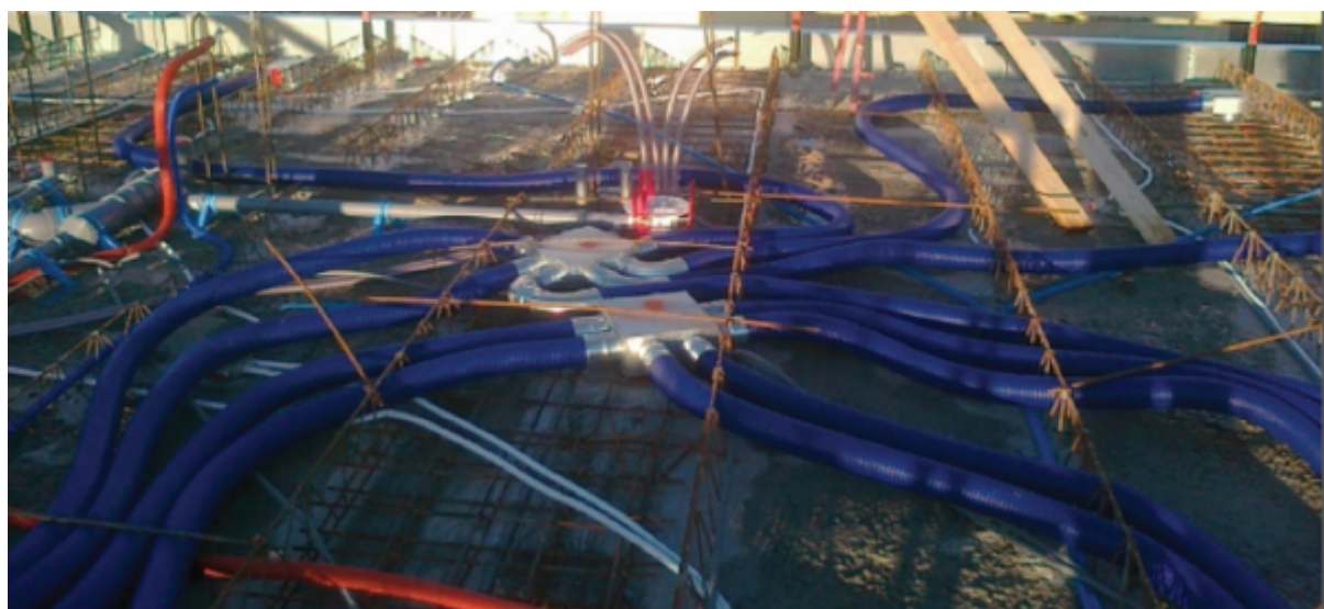
Figur 4. Nya teknik- och systemlösningar kan förväntas sänka kostnaderna när energieffektiva byggnader uppförs. Bilden visar flexibla tilluftskanaler som tar 80 mm i höjd och förenklar dragnig i mellanbjälklag. Ingjutning är dock ingen lämpligt lösning om värme ska bäras med tilluften (luftvärme).
