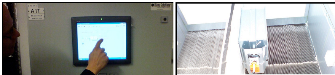
Figur 3. Genom web-övervakning av aggregat, kan ByggVestas driftsansvarige notera att valt aggregat håller nära 90% verkningsgrad även vid låga utetemperaturer.
